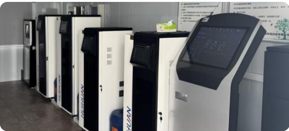
废水监测房设备
