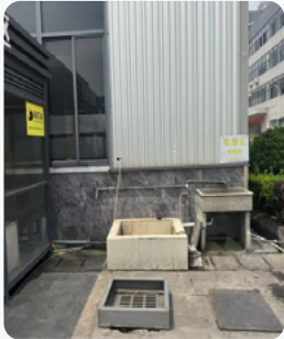
洗地板水三级沉淀池实景
