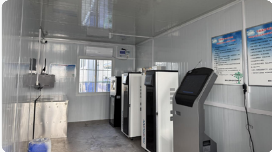
废水在线检测系统设备
